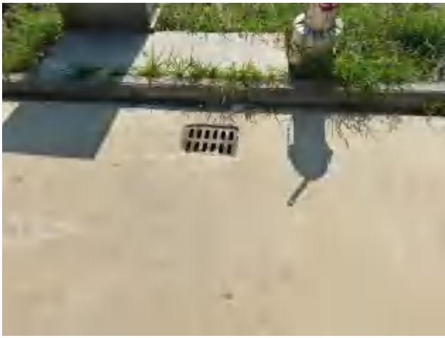
生产区雨水管道（2023年8月）
